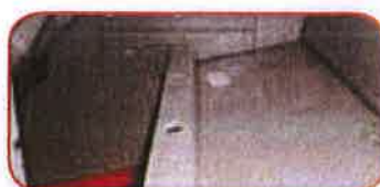
protection a l'usure pour le convoyeur principale
